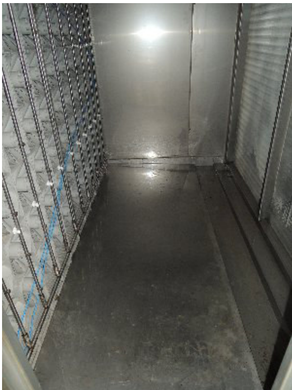
Bild 3: Düsenstock und Wärmeübertrager
